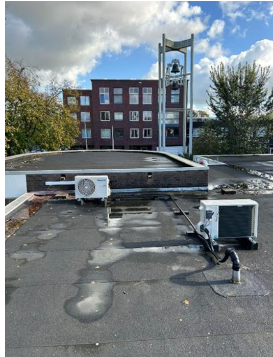
Figuur 2 de buiten units op het dak
